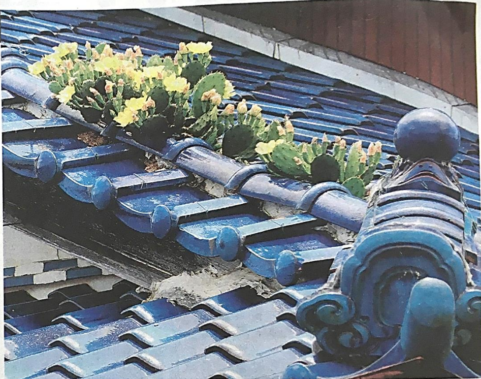
屋根瓦の隙間から生え、黄色い花を咲かせたサボテン＝美濃市極楽寺で
