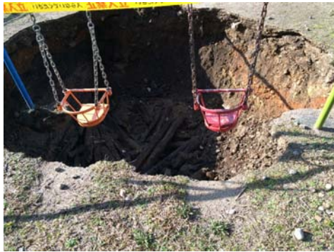
写真-1 春日井市不二ガ丘での陥没跡 (2015年3月16日撮影)
