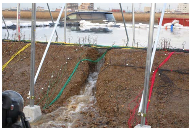
写真-4.3 切削による越流の様子
