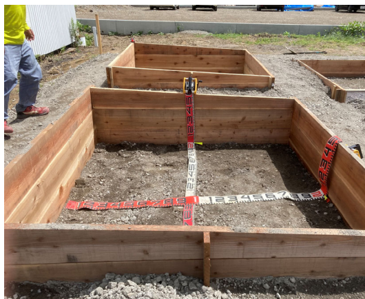
写真2 表面流出量計測サイトの杉板枠
