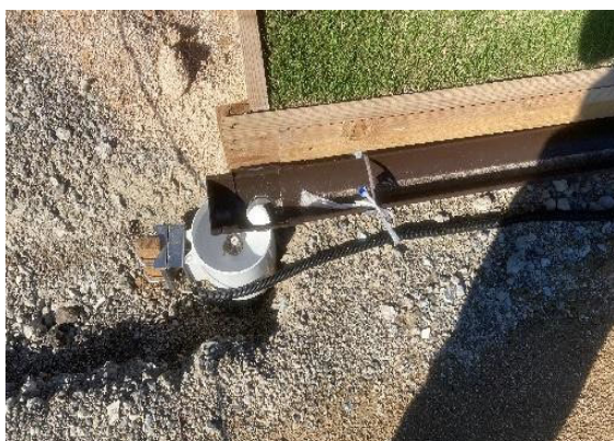
写真 11 雨樋と雨量計
