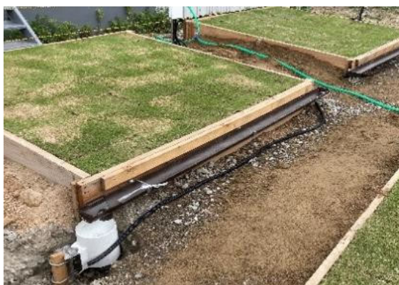
写真 10 G-Normal サイトの雨樋と雨量計
