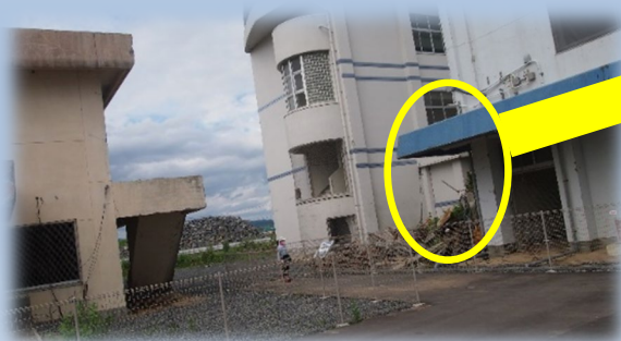
建物の間に挟まった瓦礫
