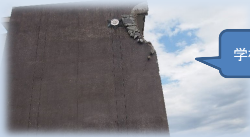
津波によって屋根が流された体育館
