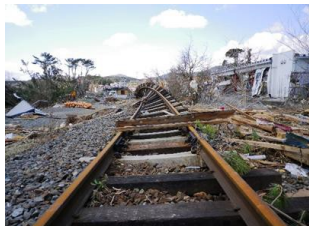
引き波によって歪んだ線路
